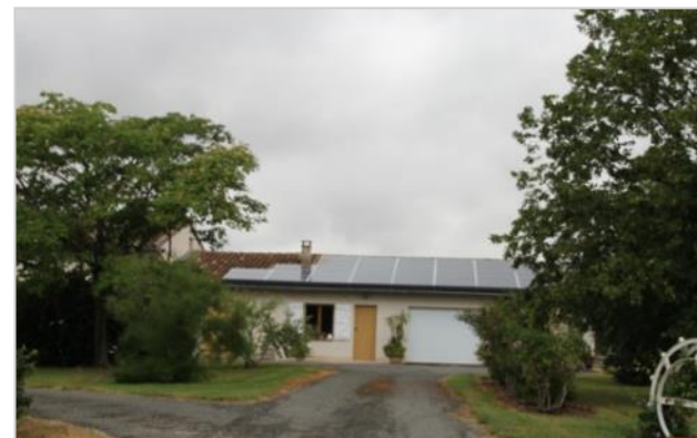
Figure 86 : Panneaux photovoltaïques sur toiture
